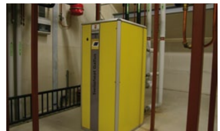
Warmtepomp voor de vloerverwarming.
