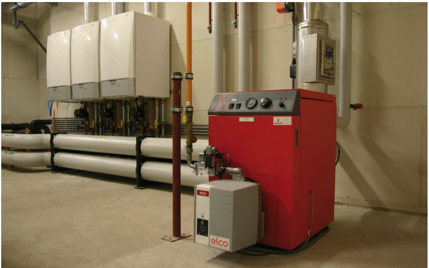
Biogasketel met op achtergrond drie piekketels op aardgas, in het energiegebouw.
