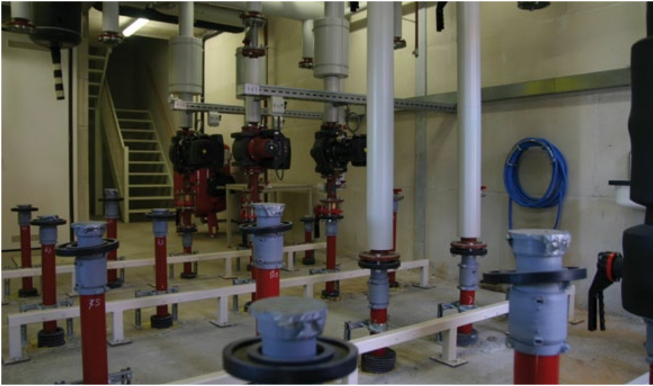
De pompen met de warmtedistributie naar de nog te bouwen woningen zijn nog niet geplaatst.
